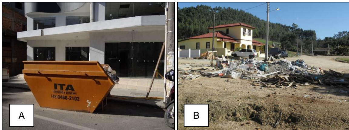
Figura 61 – A) Caçamba para recolhimento dos RCD gerados em construções e reformas no município de Orleans; B) Deposição irregular de resíduos de construção e demolição em terreno da Localidade Taipa, Agosto de 2012.
