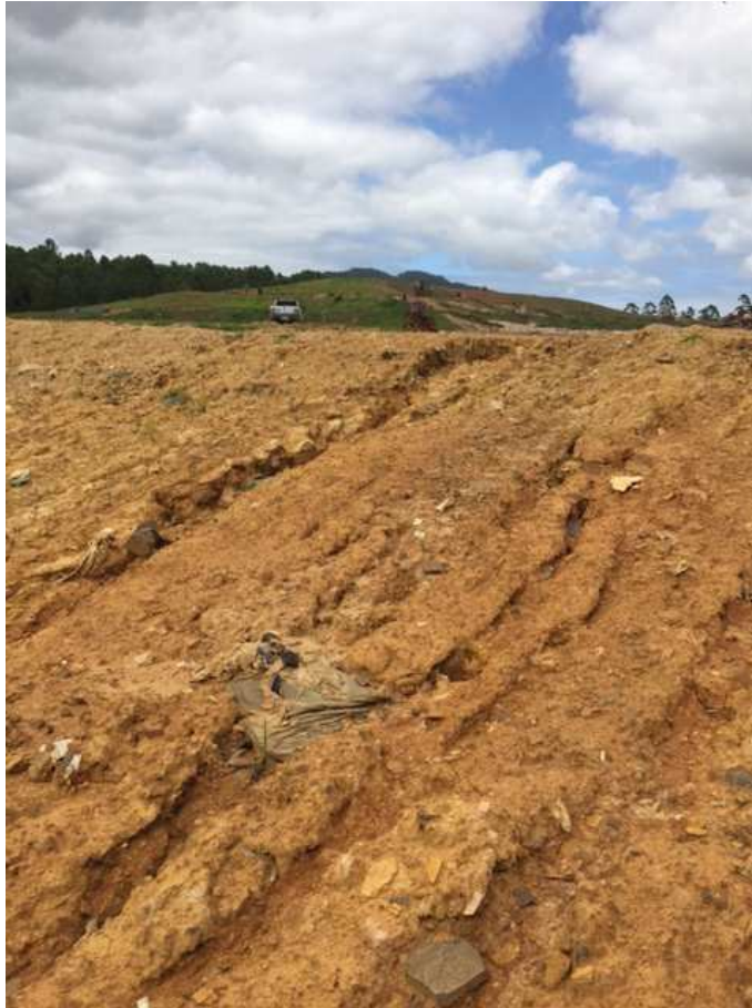
Figura 10: Sulco proveniente de processo erosivo na porção leste do talude do novo módulo.
