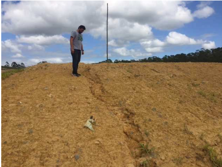
Figura 9: Sulco proveniente de processo erosivo na porção leste do talude do novo módulo.
