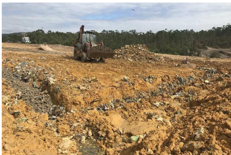
Figura 5: Interligação do sistema de drenagem de lixiviado, março de 2018.
