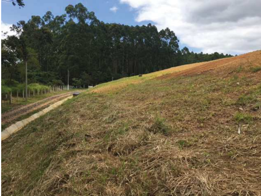
Figura 7: Detalhe da porção norte do talude sul do novo módulo de resíduos onde se observa a drenagem de pé de talude e o desenvolvimento da cobertura vegetal.
