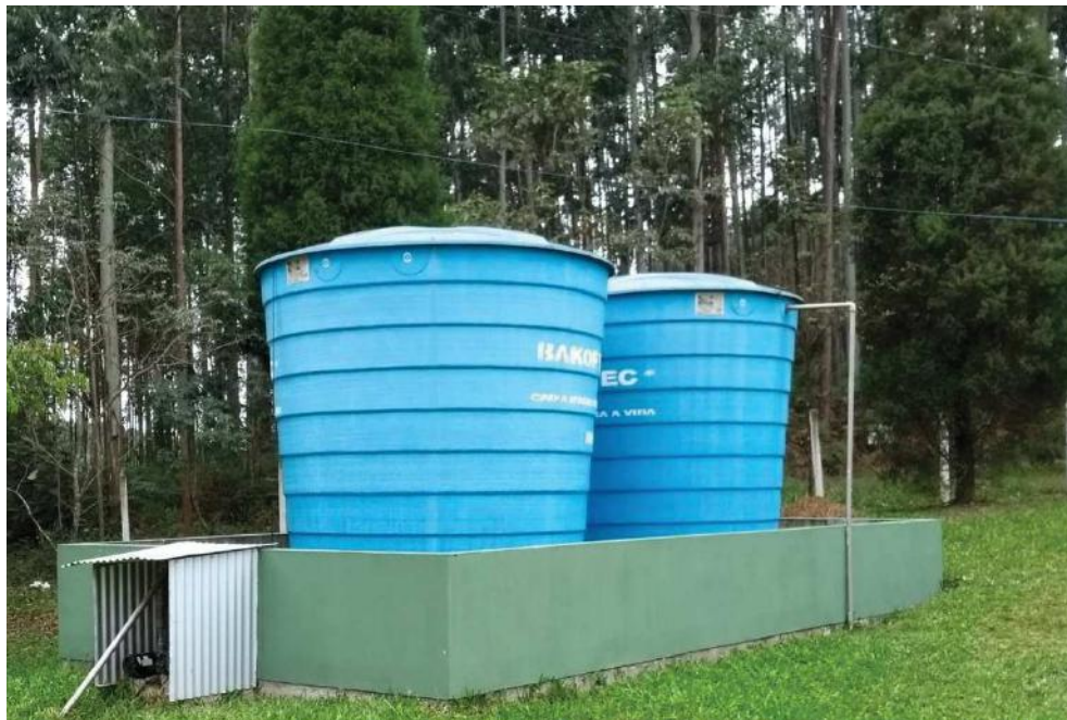
Figura 11: Caixas Retentoras de Chorume (equalização para o sistema físico-químico), maio de 2018.
