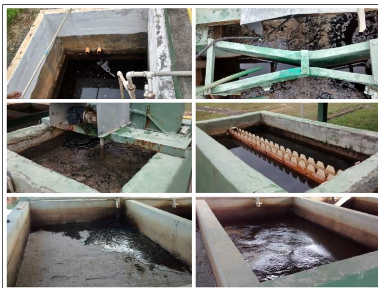
Figura 9: Sistema de tratamento físico-químico, março de 2015.
