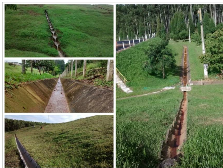
Figura 5: Sistema de drenagem pluvial, abril de 2015.
