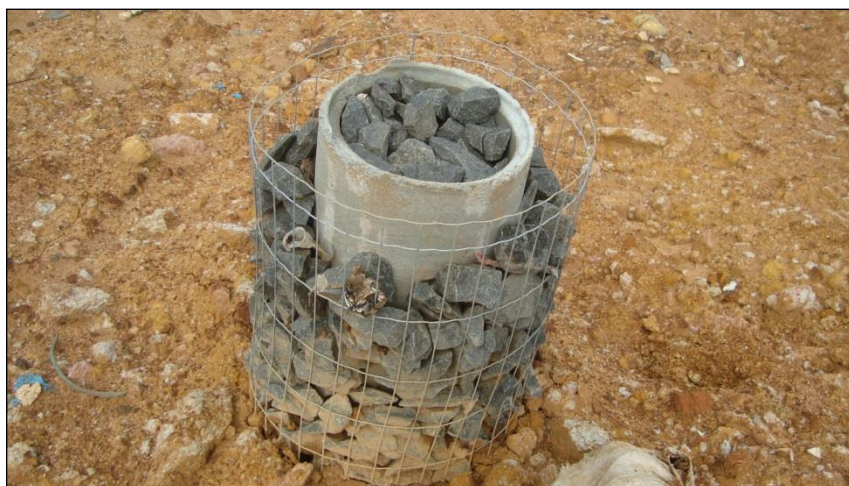
Figura 4: Queimador de gás do aterro sanitário, abril de 2014.
