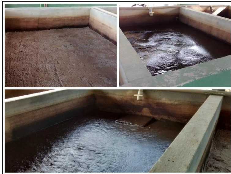
Figura 10: Leitos de secagem do lodo na ETE físico-química, abril de 2014.
