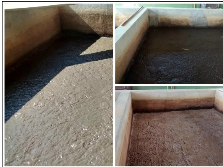
Figura 9: Leitos de secagem do lodo na ETE físico-química, dezembro de 2014.
