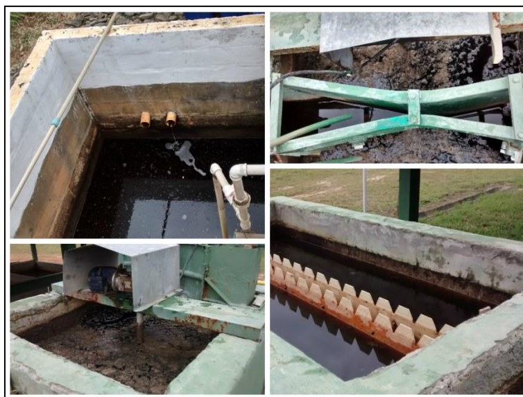
Figura 8: Sistema de tratamento físico-químico, dezembro de 2014.
