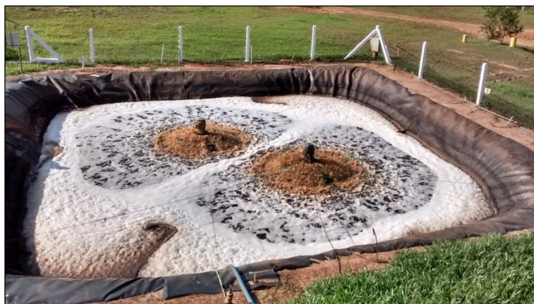
Figura 28: Lagoa aerada - Sistema de tratamento de chorume, abril de 2015.
