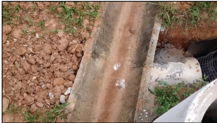
Figura 21: Transpasse e conexão da vala de drenagem com o poço de chegada de chorume.
