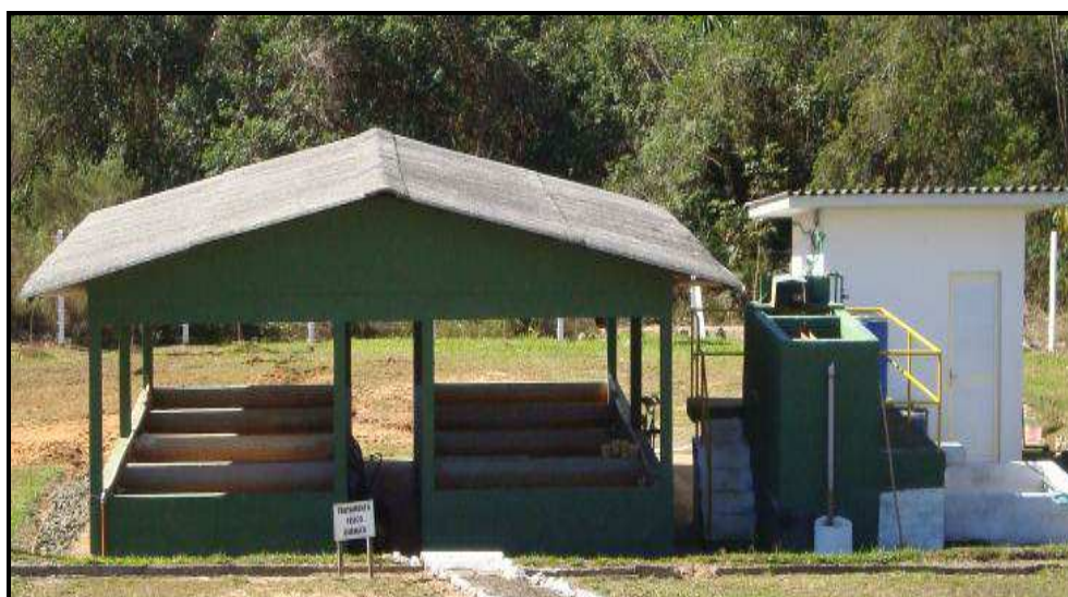
Figura 22: Vista externa do tratamento físico-químico de chorume – março 2013
