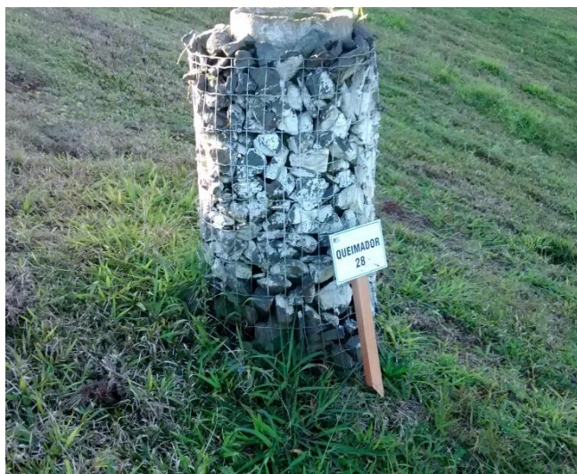
Figura 4: Queimador de gás do aterro sanitário, novembro de 2015.
