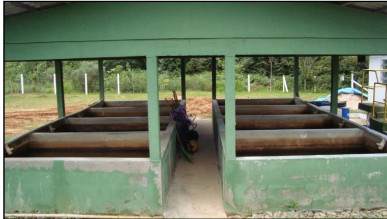
Figura 11: Leitos de secagem do lodo na ETE, dezembro de 2015.
