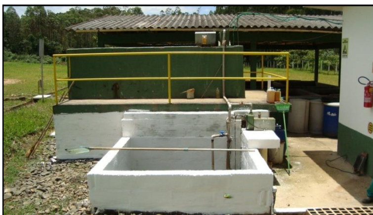
Figura 9: Sistema de tratamento físico-químico, dezembro de 2015.
