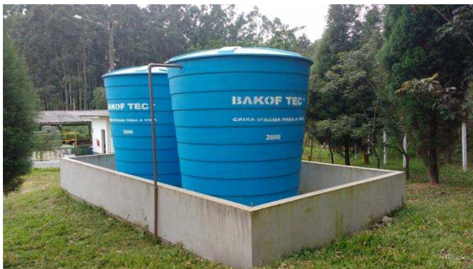
Figura 10: Caixas Retentoras de Chorume (equalização para o sistema físico-químico), maio de 2017.
