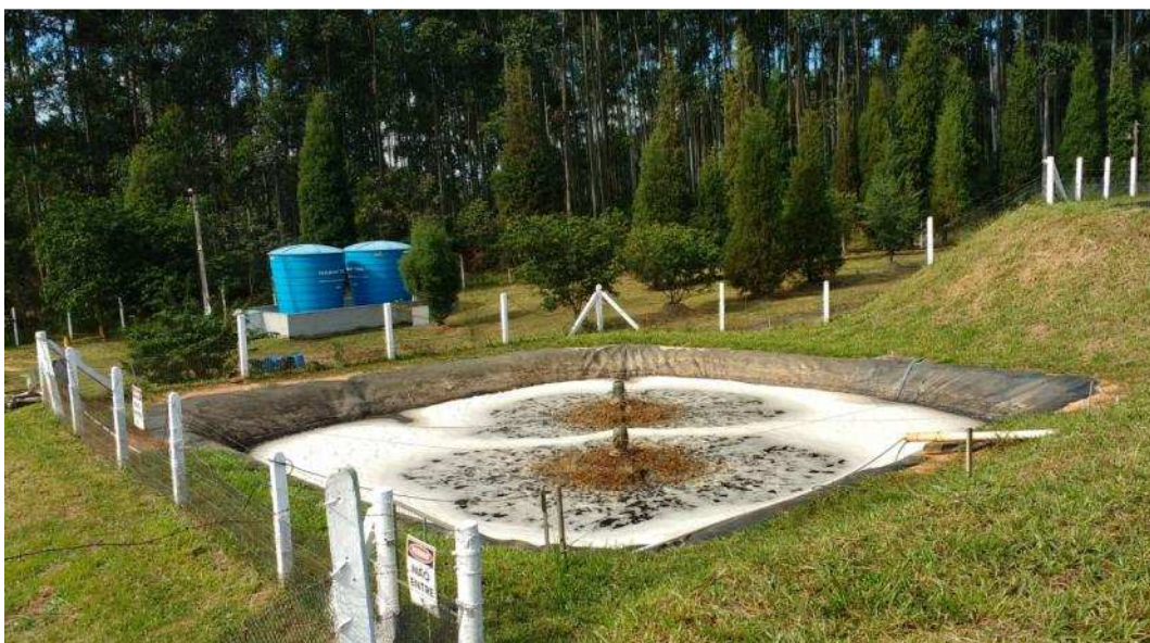
Figura 8: Lagoa aerada - tratamento de chorume, maio de 2017.
