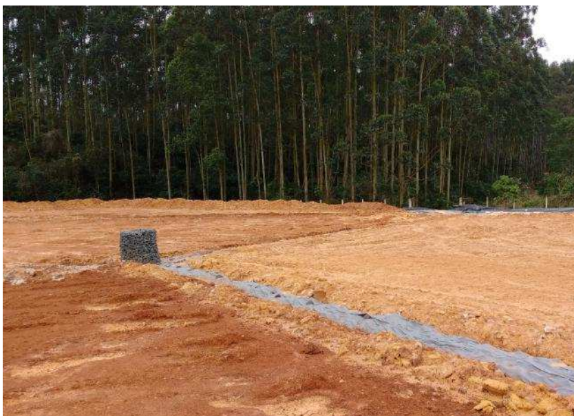
Figura 4: Sistema de drenagem de lixiviado, novembro de 2016.
