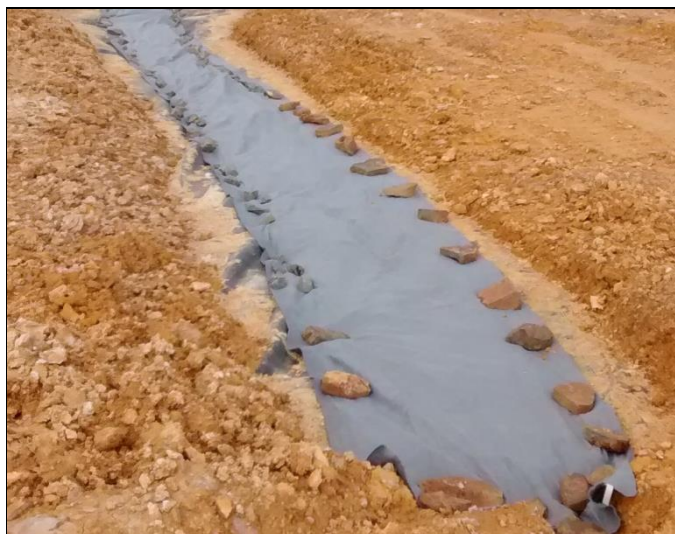
Figura 3: Sistema de drenagem de lixiviado, abril de 2016.
