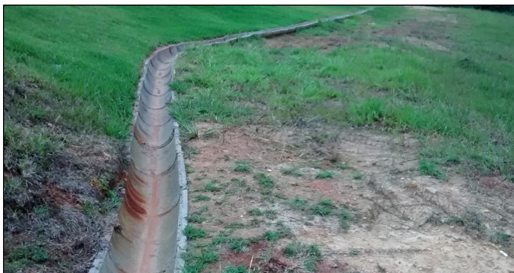
Figura 5: Sistema de drenagem pluvial, abril de 2016.
