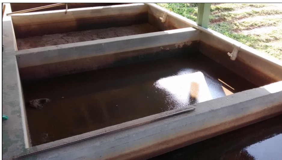
Figura 40: Leito de secagem de lodo, abril de 2016.
