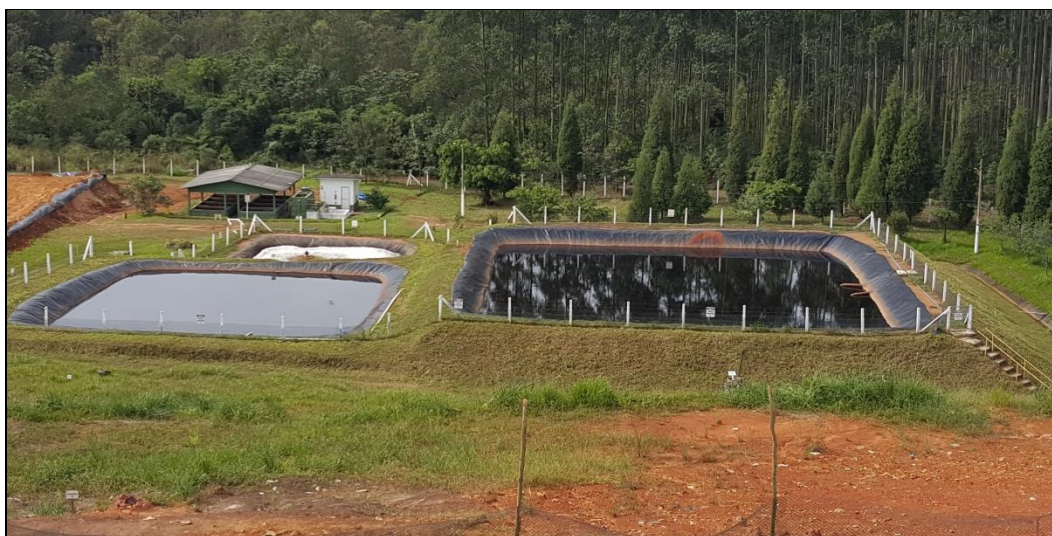
Figura 6: Lagoa anaeróbia 1 e 2 - Sistema de tratamento de lixiviado, abril de 2016.
