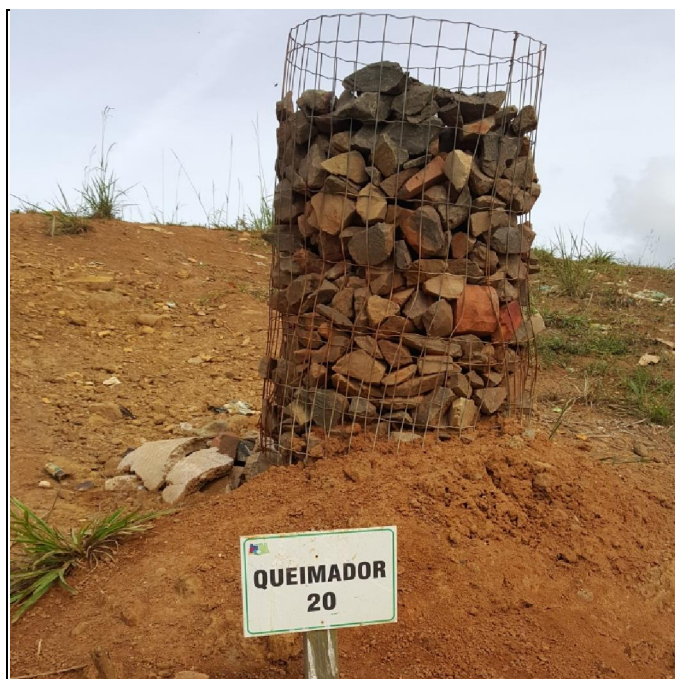
Figura 4: Queimador de gás do aterro sanitário, abril de 2016.
