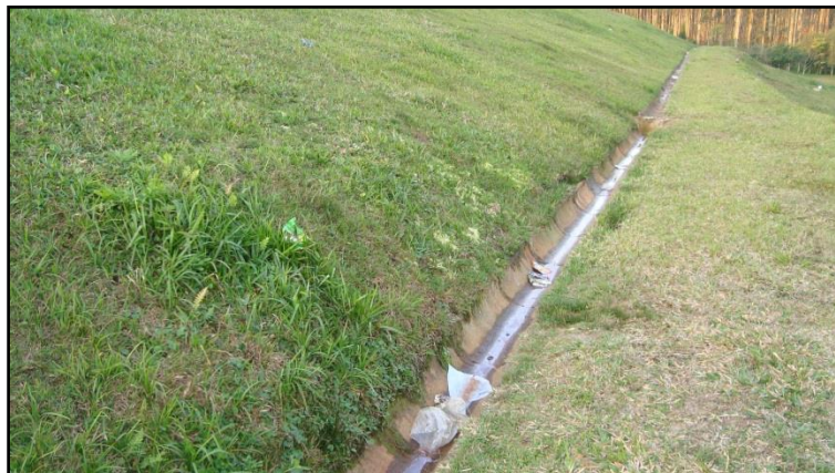
Figura 5: Sistema de drenagem pluvial, agosto de 2015.
