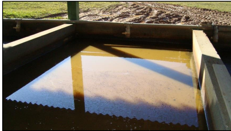
Figura 53: Leito de secagem de lodo, agosto de 2015.
