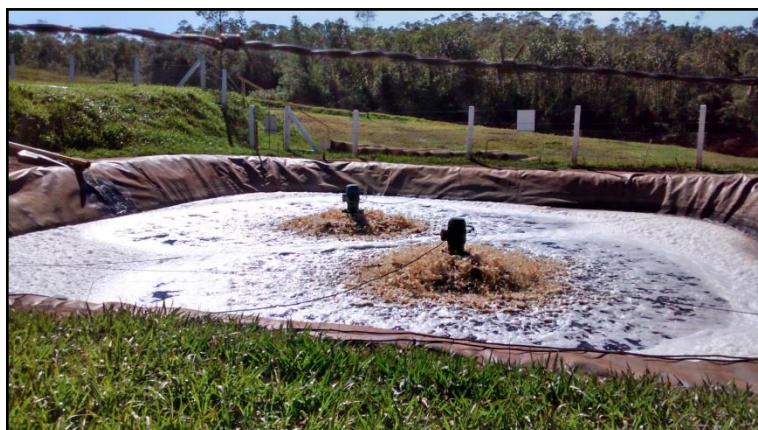
Figura 7: Lagoa aerada - Sistema de tratamento de chorume, agosto de 2015.
