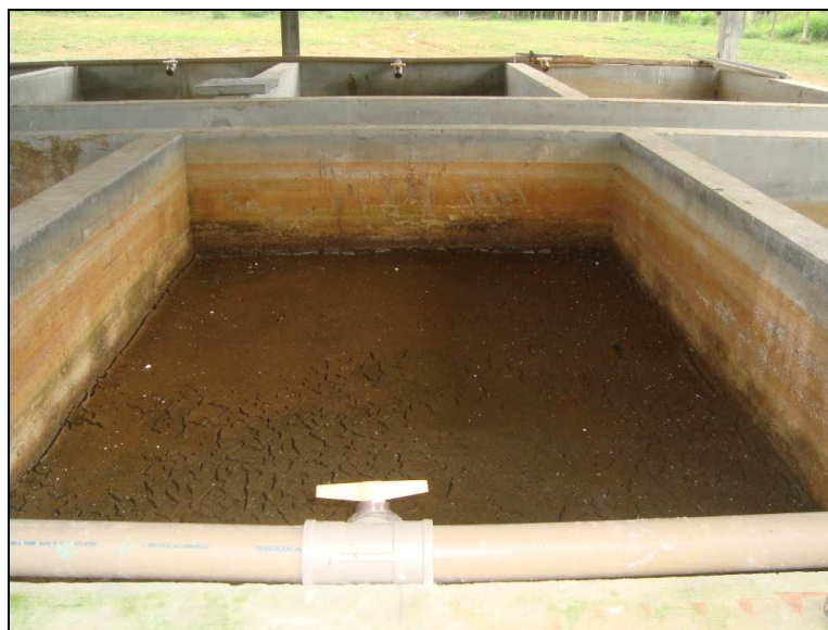
Foto 15: Lodo dos leitos secagem, março de 2010.
