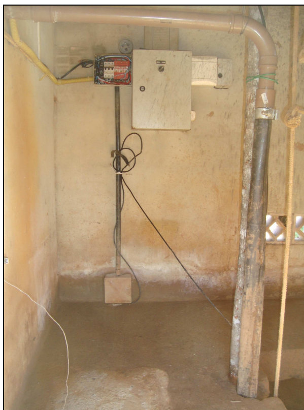
Foto 5: Estação de bombeamento do chorume, agosto 2009.
