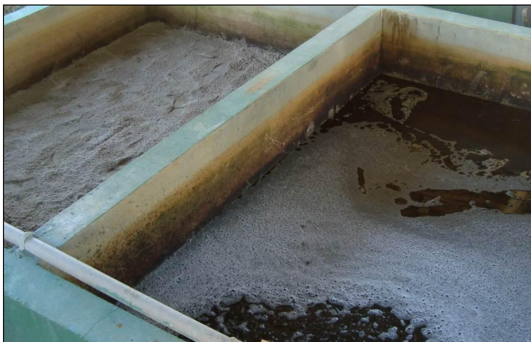
Figura 6: Leitos de secagem do lodo na ETE físico-química, abril de 2014.
