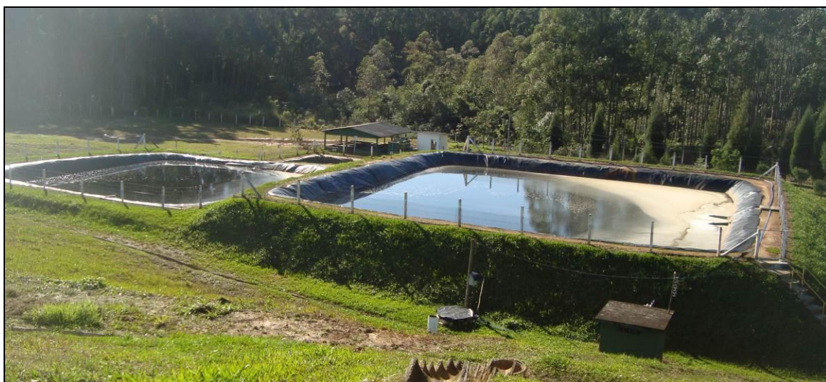
Figura 4: Sistema de tratamento de chorume, abril de 2014.
