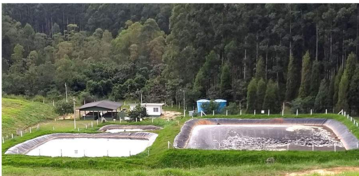
Figura 7: Lagoas anaeróbias 1 e 2 - Sistema de tratamento de chorume. Ao fundo sistema de tratamento físico-químico, março de 2019.
