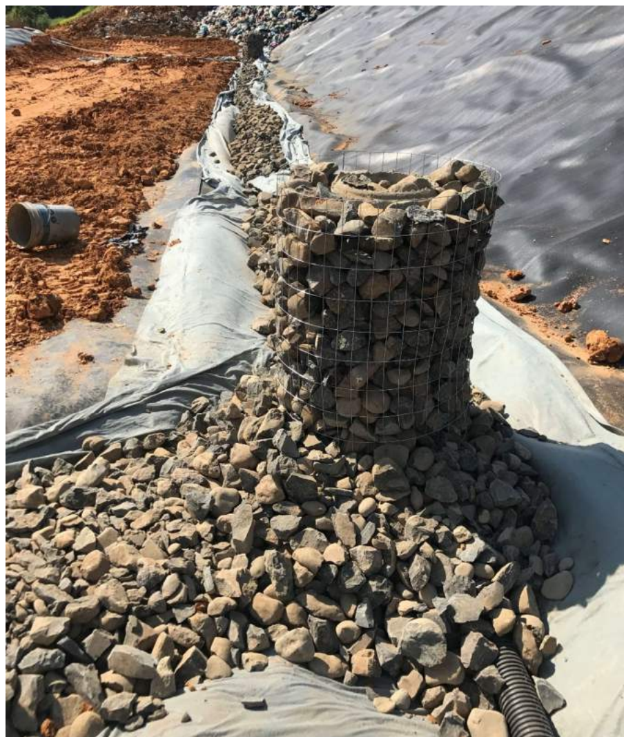
Figura 4: Sistema de drenagem de lixiviado, fevereiro de 2019.
