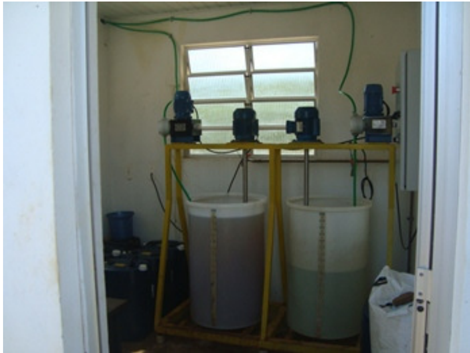
Figura 10: Vista interna do sistema de tratamento físico-químico de chorume, dezembro de 2011.
