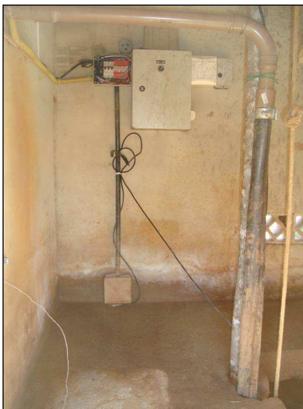
Figura 6: Estação de bombeamento do chorume, agosto de 2010.
