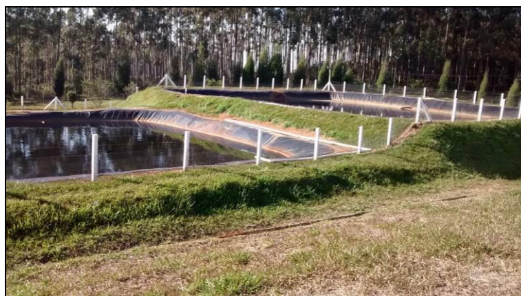
Figura 5: Lagoas anaeróbias - Sistema de tratamento de chorume, agosto de 2014.
