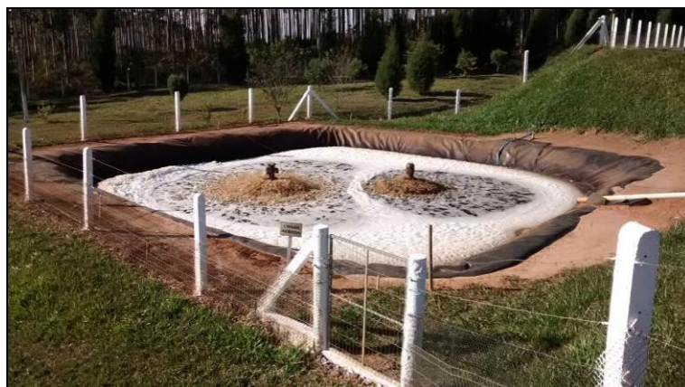
Figura 6: Lagoa aerada - Sistema de tratamento de chorume, agosto de 2014.
