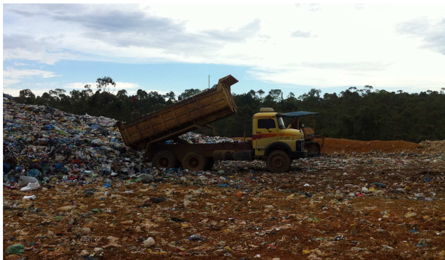
Figura 2: Cobertura da massa de resíduos, novembro de 2013.
