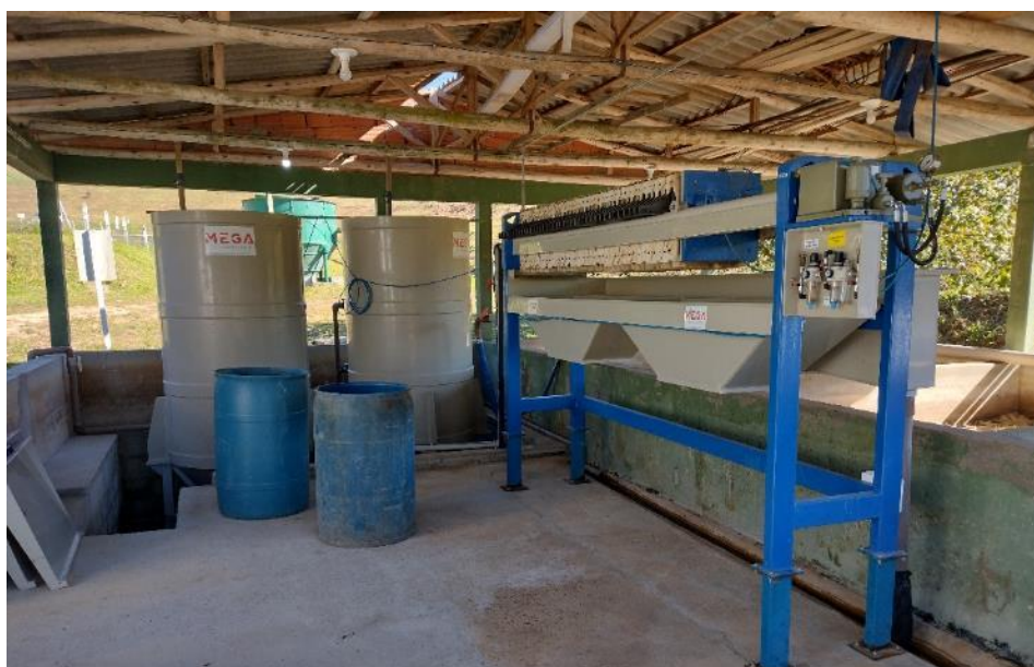
Figura 13 – Filtro Prensa e tanques adensadores da ETE.
