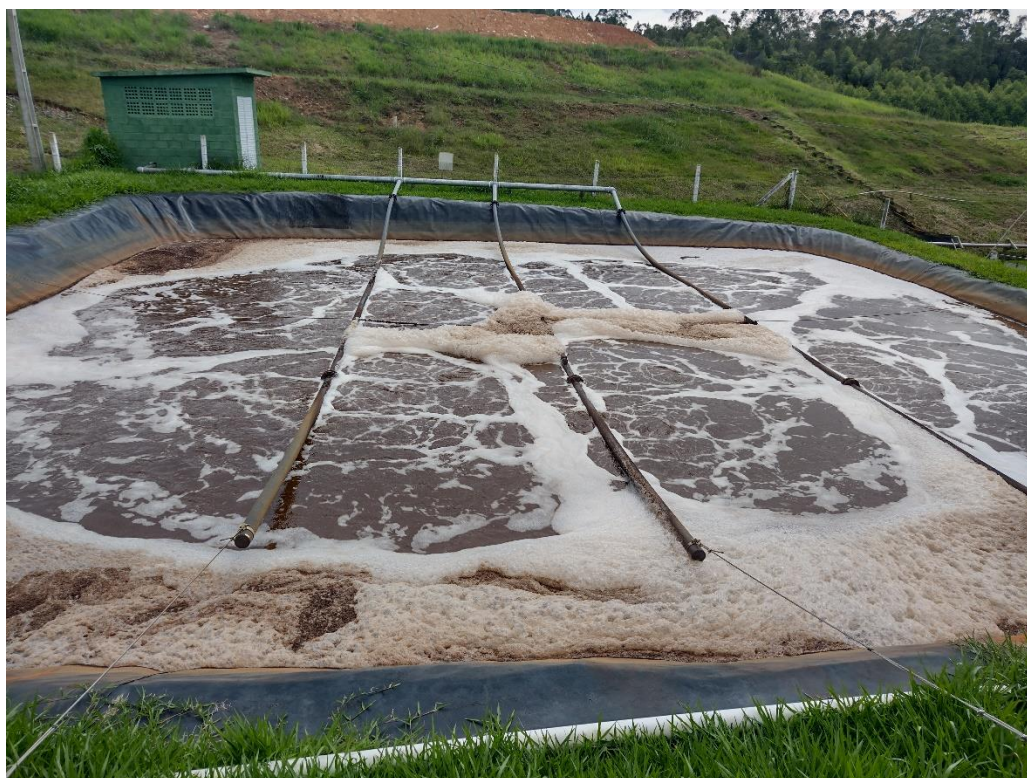
Figura 12 – Lagoa aerada com novo sistema de aeração – abril 2022.
