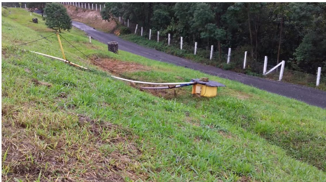
Figura 6: Sistema de bombeamento de lixiviado, março de 2022.
