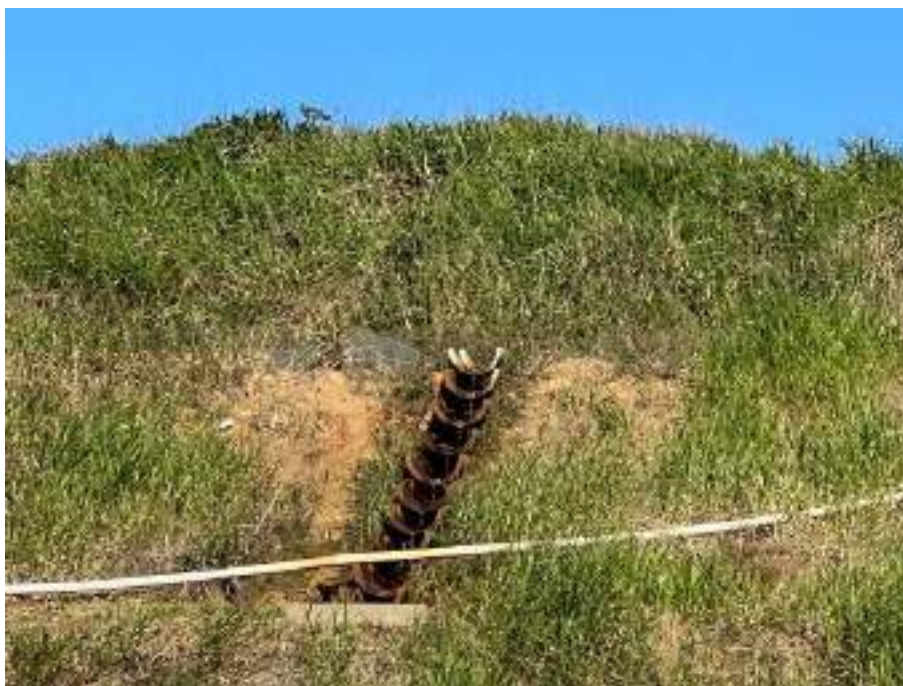
Figura 5: Dissipador de energia do sistema de drenagem das águas pluviais.
