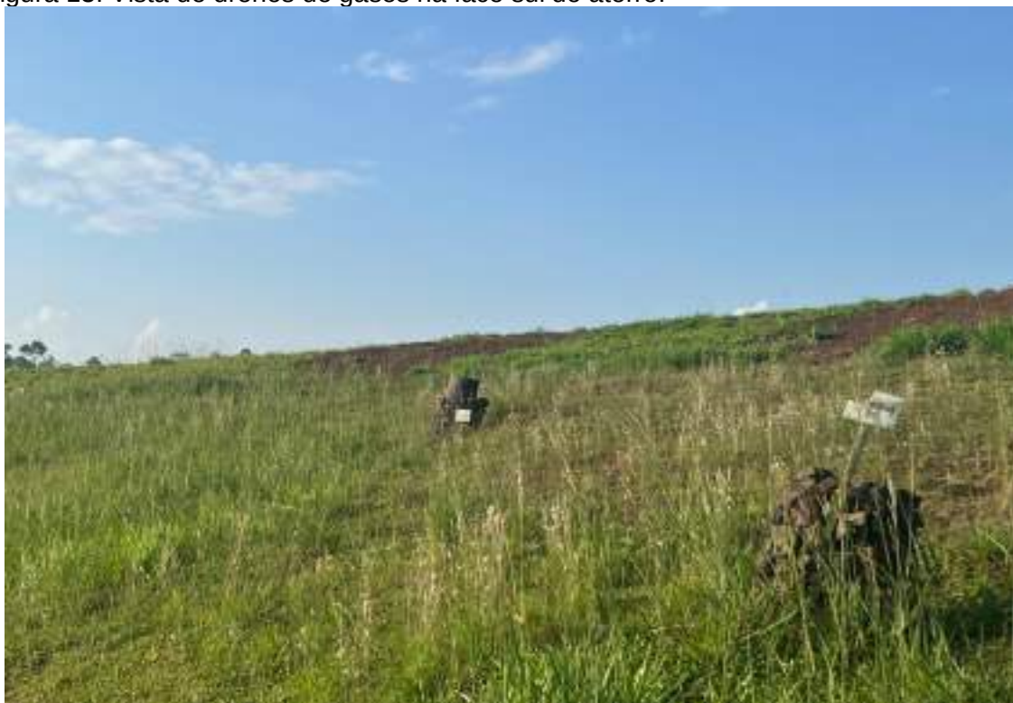
Figura 13: Vista de drenos de gases na face sul do aterro.
