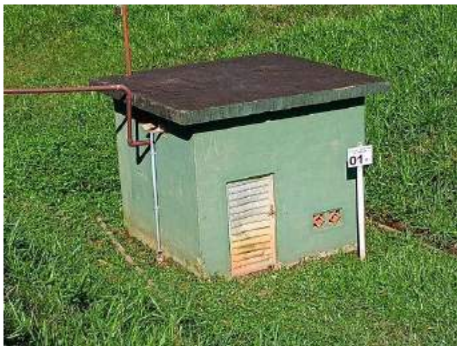
Figura 7: Sistema de bombeamento de lixiviado, maio de 2024.
