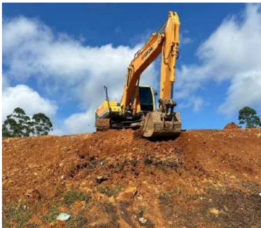
Figura 17: Manutenção dos taludes e vazamentos de chorume, dezembro de 2024.
