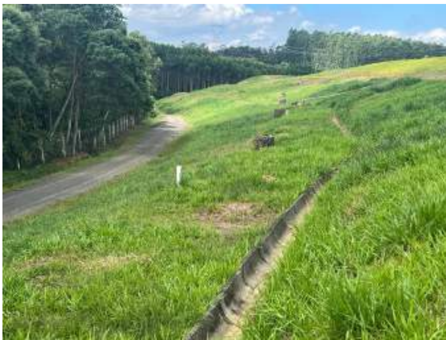
Figura 4: Vista de um trecho do sistema de drenagem de águas pluviais.
